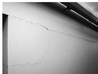
壁に入ったひび割れ
