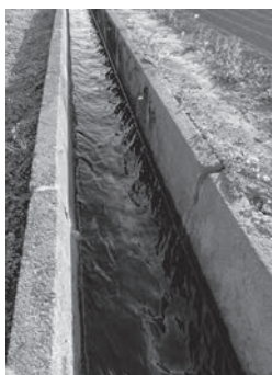
普門寺の近くにある側溝。水が奥からまっすぐ流れている
