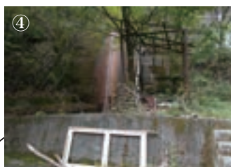
プレハブ小屋は骨組みだけが原形をとどめる。奥の赤い壁は堰堤
